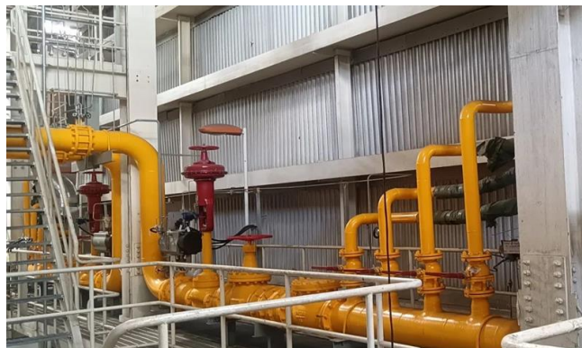
神华台山电厂600MW机组掺氨燃烧项目 Taishan Project in Guangdong
