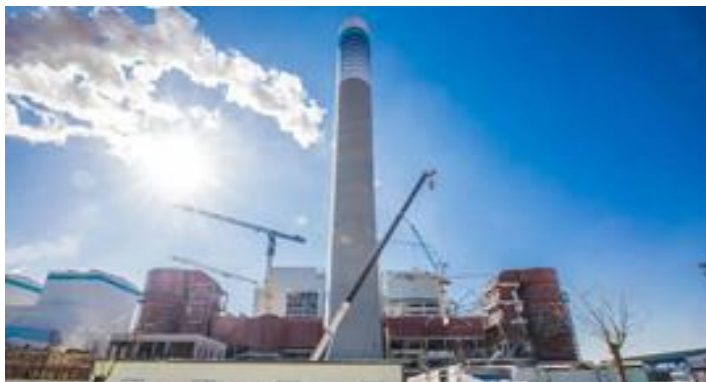
国华锦界电厂捕集与封存全流程示范项目 CCUS Project in Jinjie Power Plant
